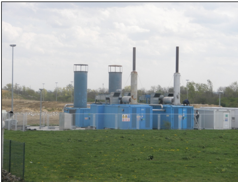
Slika 5. Postrojenje za gospodarenje plinom
